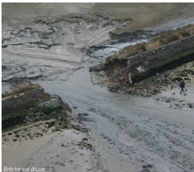
Brèche sur digue
