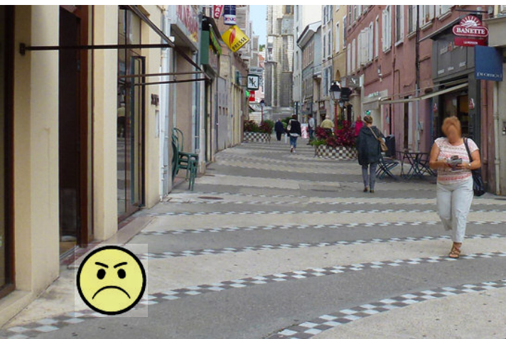
Une personne mal-voyante peut confondre les motifs du revêtement avec des dénivélés
