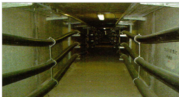
Ligne 400 000 V en tunnel
